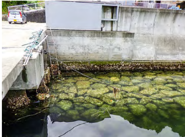
写真 6 亀山地点の状況。ロープおよび梯子に浮遊ゴミが巻き付いている。
