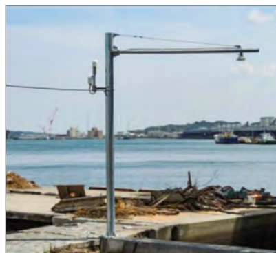
写真 1 センサー設置状況 パルサーソフト提供
