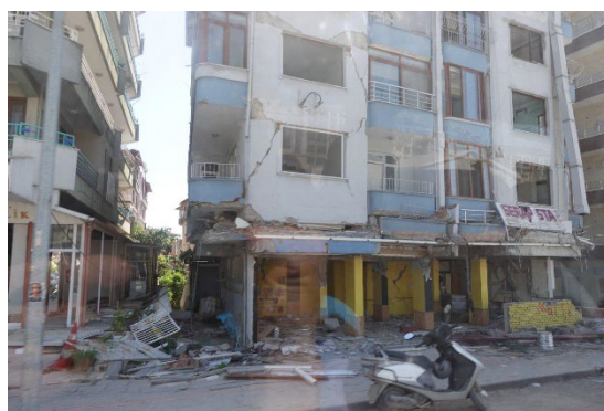
2階が層崩壊した建物（アンタキヤ）
