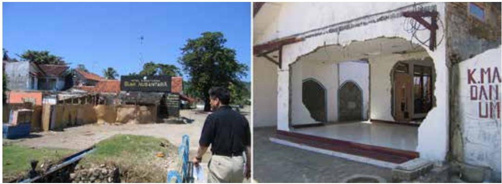
Photo. 3 Pangandaran の Bumi Nusantara Hotel の外観 (左) と内部 (右) 屋根は無事であったが、部屋の内部は天井近くまで浸水が達し、壁面はほぼ全面的に流失していた
