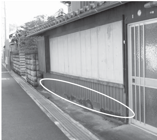
写真 3 外壁下部の金属面の錆
