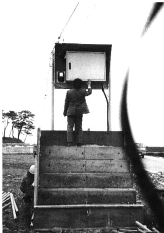
写真5 センサー部コンピューター格納容器
