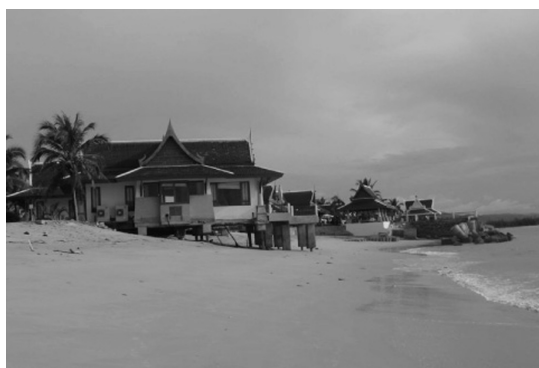
写真 1 津波後の海岸侵食によって建物の基礎が露出する宿泊施設 2010 年 11 月撮影
