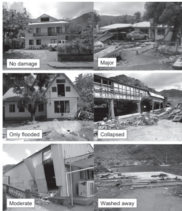
写真 8 現地調査による建物被害の分類例
