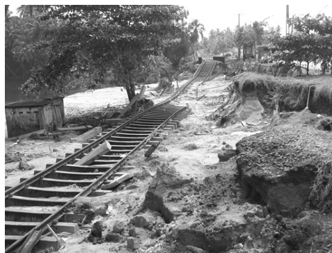
写真一 9 鉄道基礎の侵食 (スリランカ)
