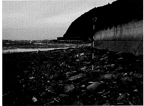
図 17-2 浮遊物帯が堤防の手前に形成されていた.
