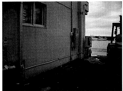
図 85-2 外壁の浸水線
