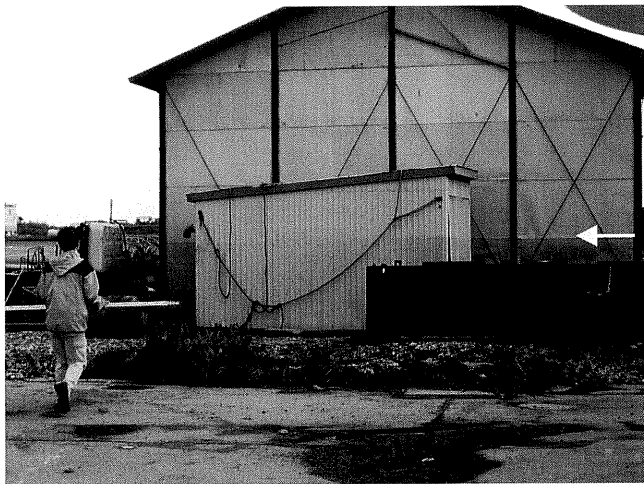
図 127-1 建物壁に残された津波の痕跡。土砂による茶色ではなく黒ずんだ色をしている。これは重油などが停滞していたことを示唆する。(地点番号 127)
