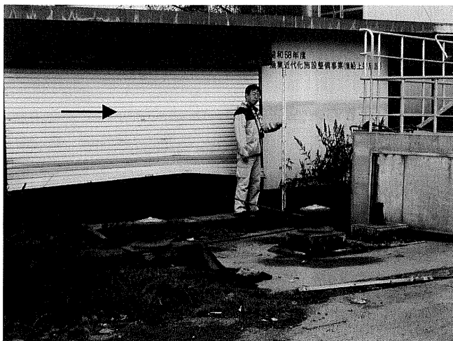
図 117-1 建物壁に残された津波の痕跡. 土砂による茶色ではなく黒ずんだ色をしている. これは重油などが停滞していたことを示唆する. (地点番号 117)
