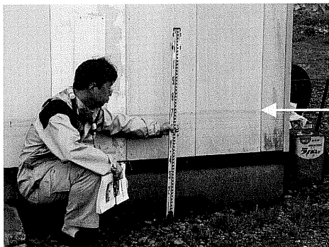
図 50-1 水塊が長時間滞留していたので、壁の色が変化している。（地点番号 50）
