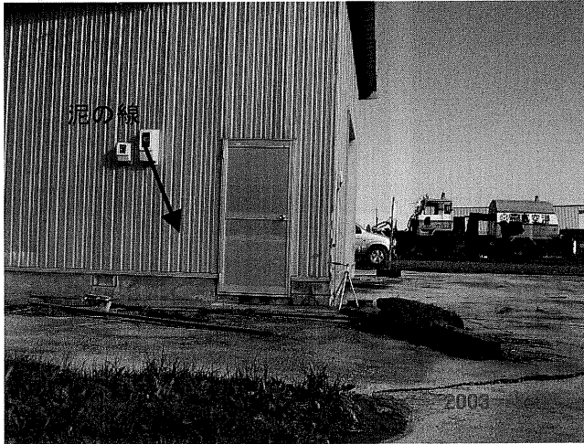
図 75-1 十勝港内の津波の痕跡
