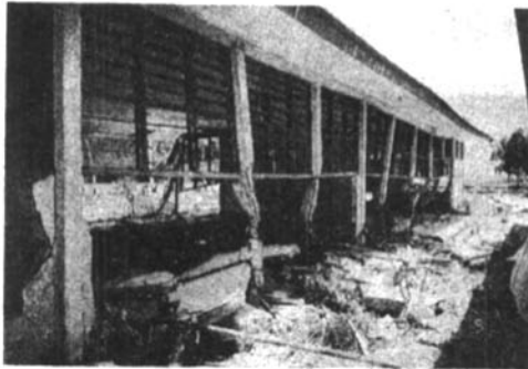
写真-9 破壊された建物の例 (1996年イリアンジャヤ地震津波)
