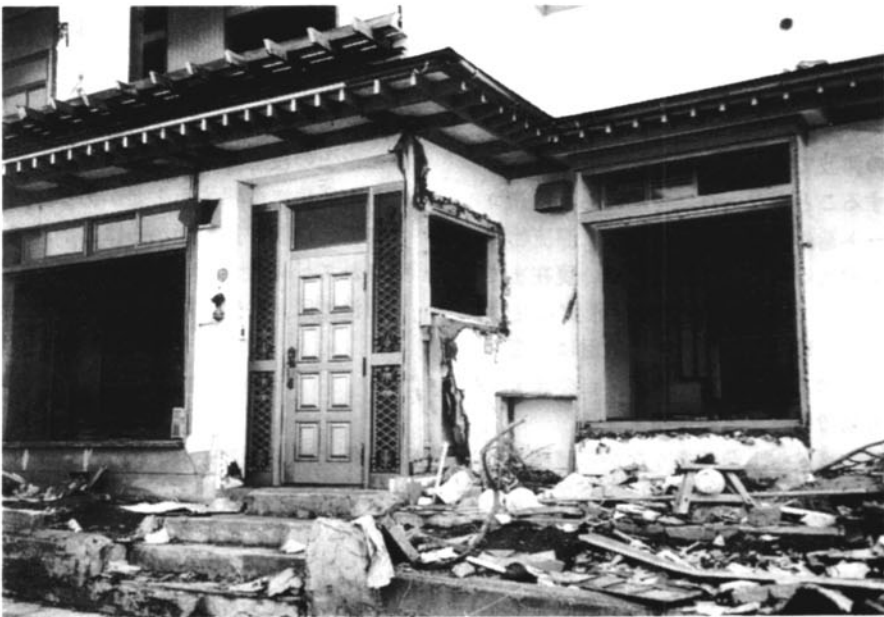
写真-9(4) 鎌田家の道路に面した部分。ガラス障子は吹き飛ばされたが、ドアは残った。
