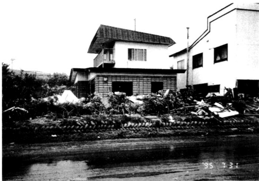
写真-6 青苗1区の渡辺家。道路からやや引っ込んでいる。一階がブロック壁であったため、窓などが壊れたにも関わらず、浸水ですみ、柱も折れなかった。これより津波の流れとしては下流に当たる大村家（写真-7）と好対照である。
