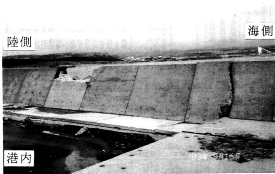
写真-2 青苗漁港北防波堤の一部折損
