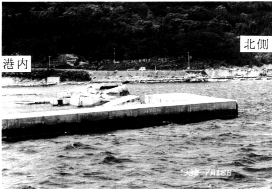
写真-3 奥尻港北防波堤の被災状況
